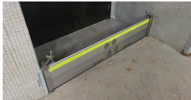
富豪機場酒店的防洪閘
